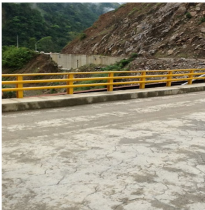
Puente la honda k18+217 fisuras y grietas losa
