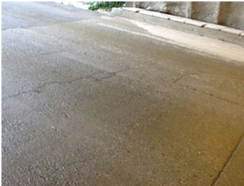
Túnel 6 Fallo estructural losas grietas en bloque
