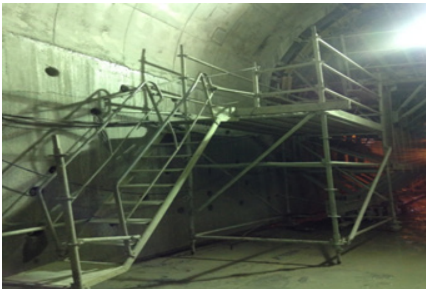
Andamios armados sin tags de seguridad
