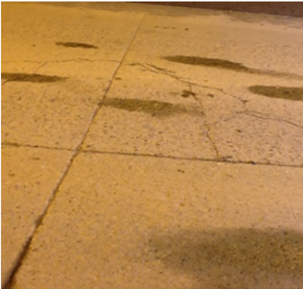
Túnel 6 Fallo estructural losas grietas en bloque
