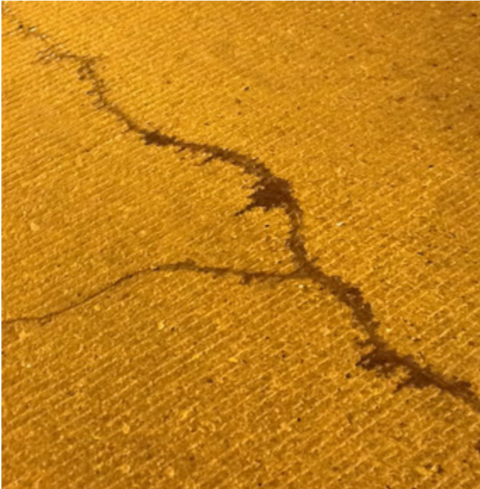
Túnel 8 Fallo estructural losas, grieta en bloque
