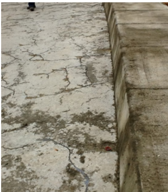
Puente la honda k18+217 fisuras y grietas losa
