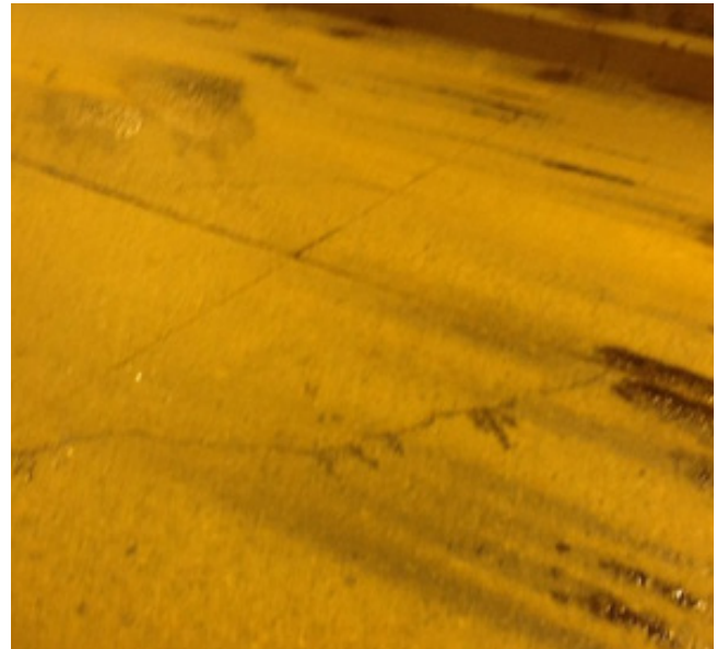
Túnel 6 Fallo estructural losas
